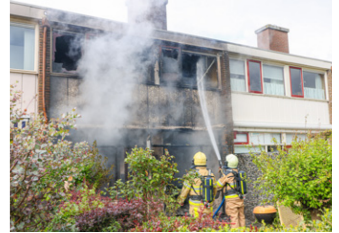
Woning helemaal uitgebrand in Steenwijk.
